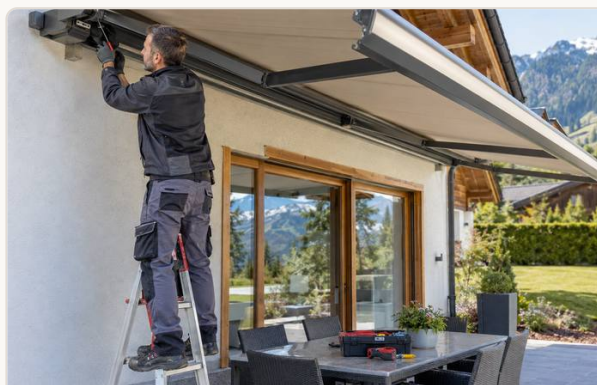
Mantenimiento de toldos
